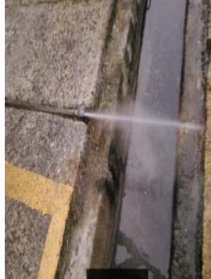
Fuga de agua
